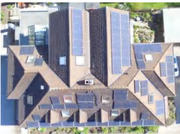
Mehrfamilienhaus, 17kWp, Kehl 12/2019
