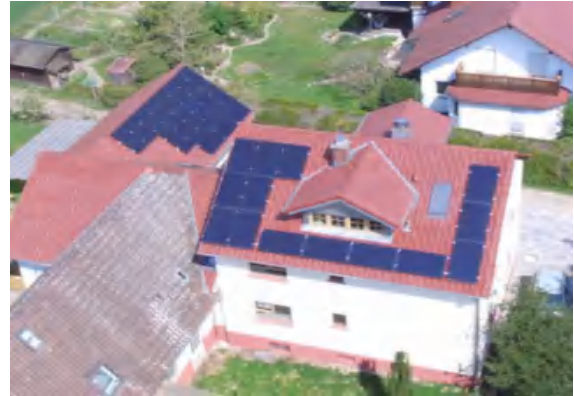
Einfamilienhaus, 10kWp, Schutterwald
