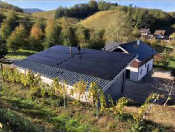
30kw auf Halle in Oberkirch, 10/19
