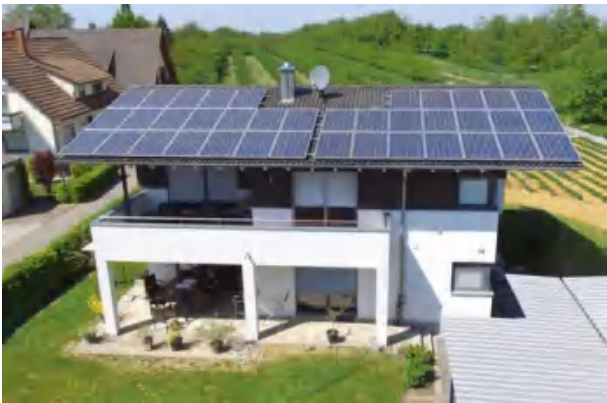
Einfamilienhaus, 10kWp, Haslach, 2016
